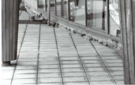
◀平然と見える塩竈港だが、 建物には多くの亀裂が目立つ。
